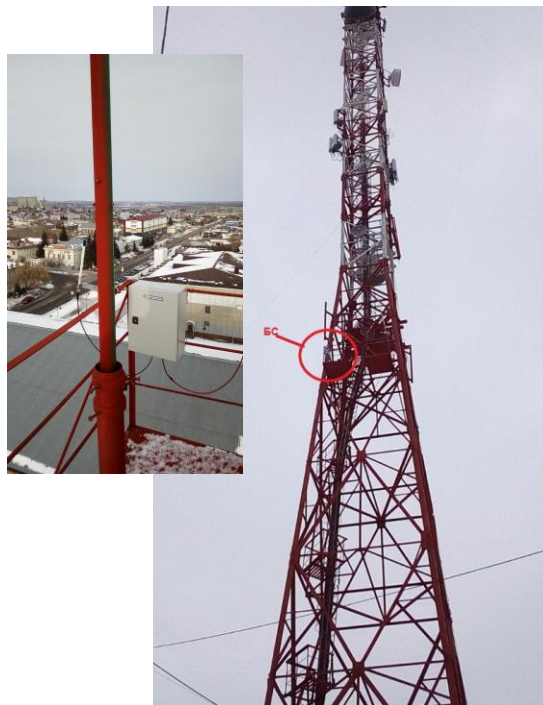
Базовая станция сети LoRaWAN
