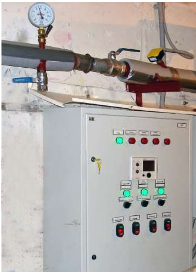
ИТП. Система автоматизированного управления теплоснабжением
