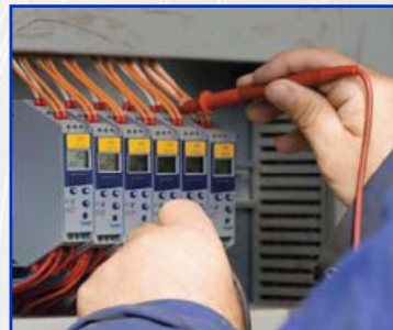
Системы автоматизации для повышения надежности и безотказности энергоснабжения
